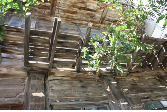
Fig. 3: Güney cephe zemin kat üst hizasındaki ahşap çıkma
