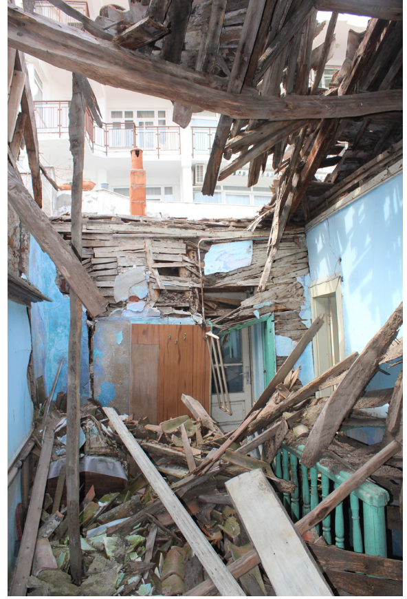
Fig. 4: Hasar görmüş ikinci kat ve çatı
