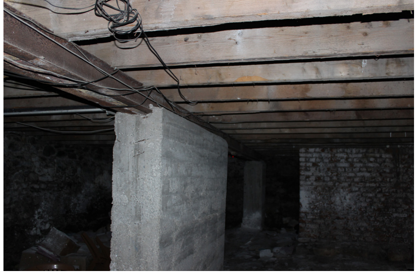
Fig. 4: Bodrum kat, betonarme müdahale
