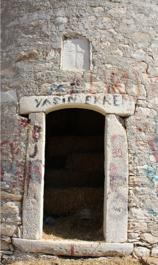
Fig. 8: Ekinlik Değirmen 2, giriş kapısı, kitabe ve vandalizm
